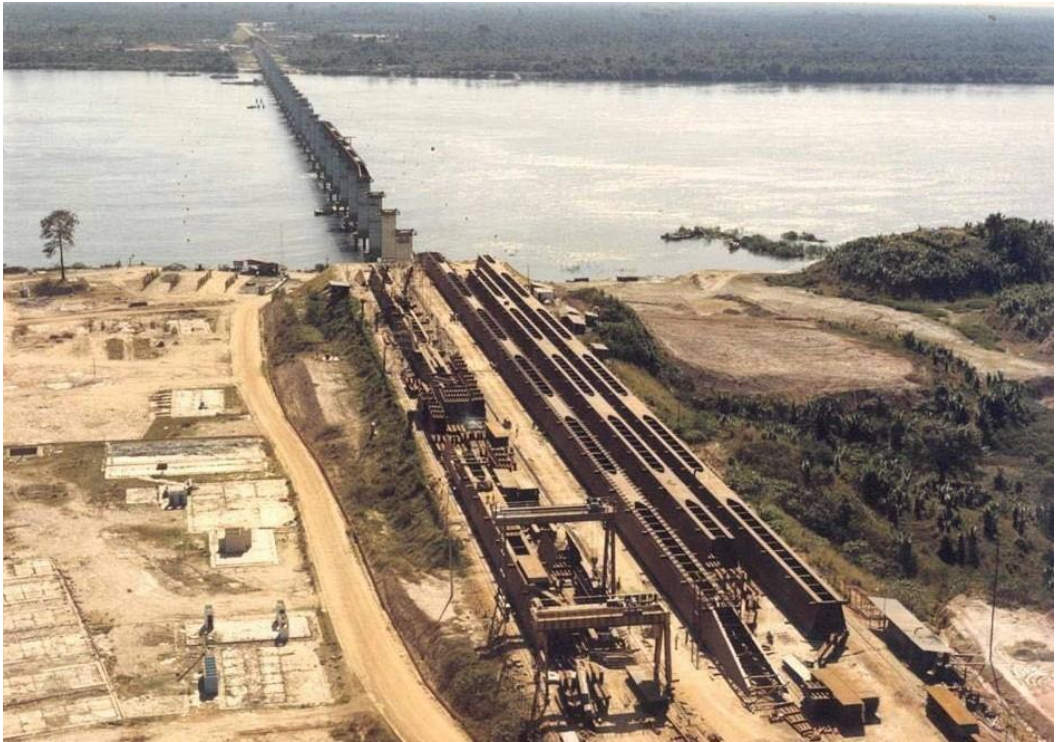
Figura 5 – Construção da ponte rodoferroviária sobre o rio Tocantins, infraestrutura decisiva para a superação de barreiras espaciais à circulação de mercadorias, especialmente o mineiro de ferro, Marabá, 1983.
